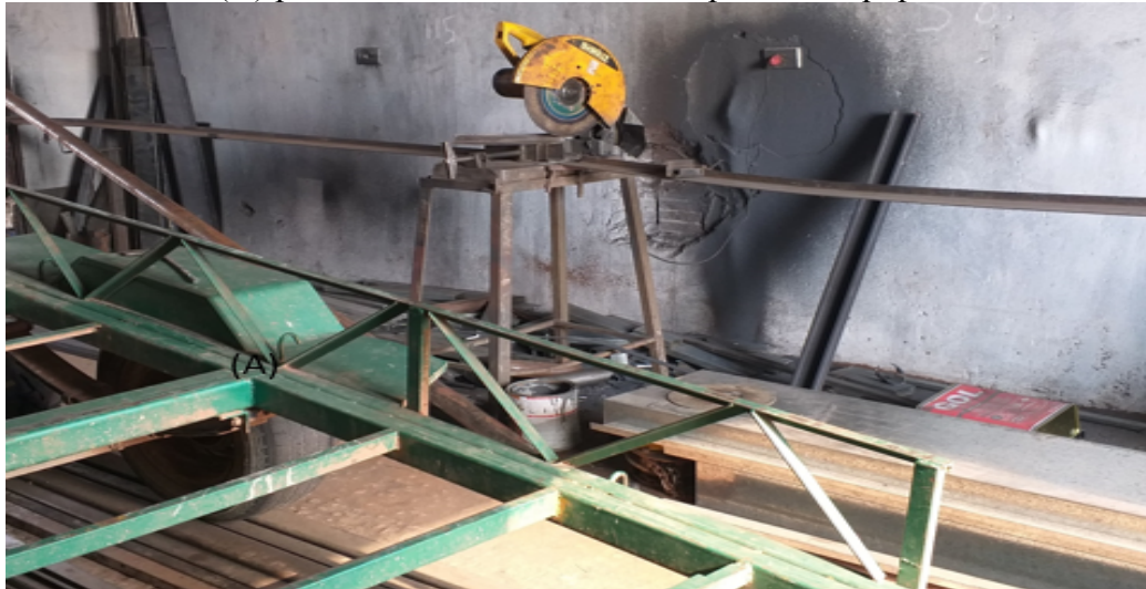
Figura 5 - Má organização próximo a equipamentos ocasionando a falta de espaço. Observe em (A) produtos e materiais colocado próximo equipamentos
