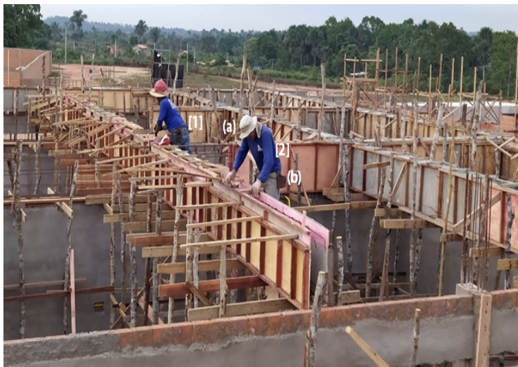
Figura 1. Operários sem o EPI's a) sem capacete, b) sem a cinta de amarração.
