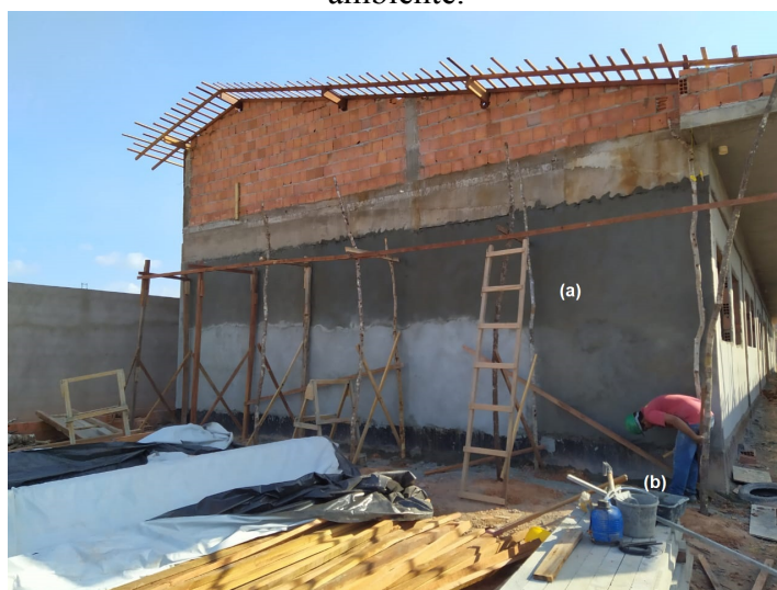
Figura 3. Uso irregular de escadas a) escadas de forma irregular, b) desorganização do ambiente.
