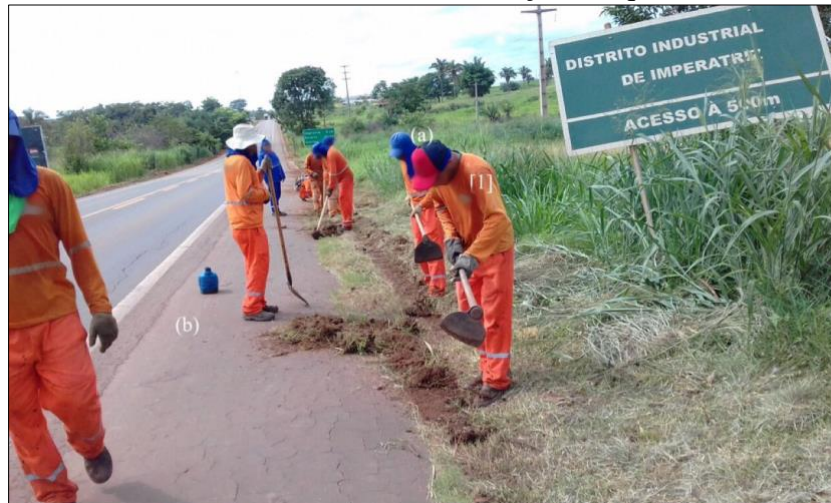
Figura 4. Inconformidades encontradas nos trabalhadores [1]: ausência de (a) balaclava, (b) local de trabalho sem sinalização adequada.
