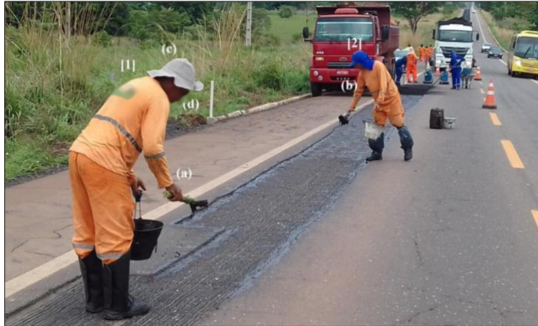
Figura 2. Inconformidades encontradas nos trabalhadores [1] e [2]: ausência de (a) luvas, (b) vestimentas para proteção do tronco (c) capuz ou balaclava (d) mascarar.
