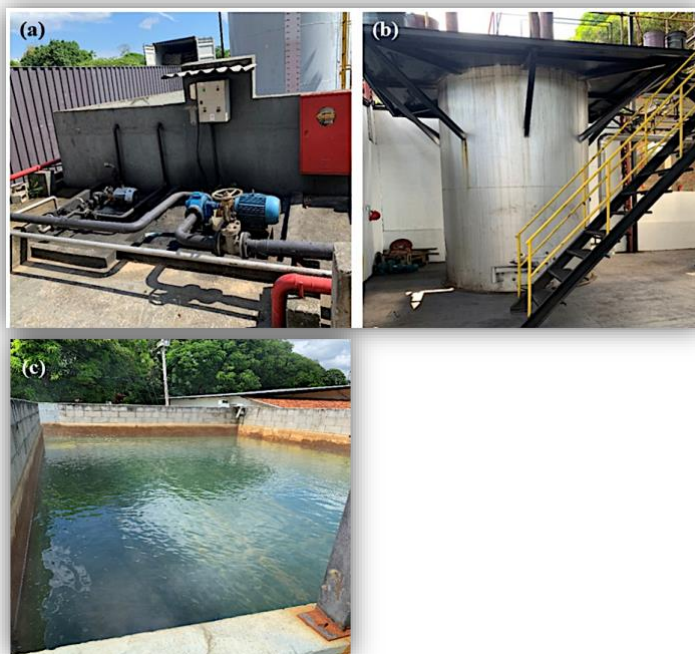
Figura 3. (a) Canalização do óleo no processo de rerrefino. (b) Tanque de desidratação do OLU. (c) Resfriamento da canalização
