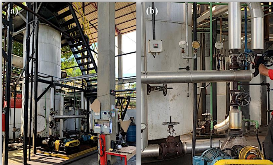
Figura 4. (a) Tanque de sulfonação. (b) Controle e monitoramento da pressão
