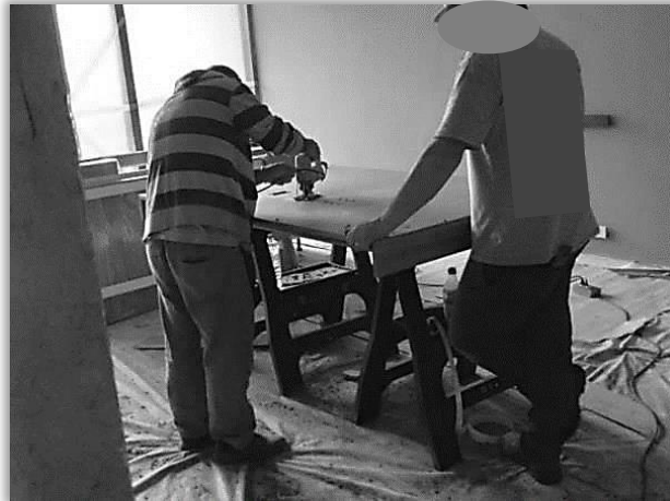
Figura 5. Risco físico: falta de protetor auditivo. Risco de acidente: ausência de equipamentos de proteção individual (capacete, óculos e luvas de segurança)
