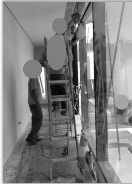
Figura 7. Risco de acidente: falta de equipamentos de proteção individual (óculos e luvas de segurança, protetor facial, avental, perneira e mangote de raspa)
