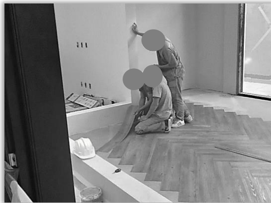
Figura 6. Risco de acidente: falta de equipamentos de proteção individual (capacete, luvas e calçados de segurança). Risco químico: ausência de protetor respiratório
