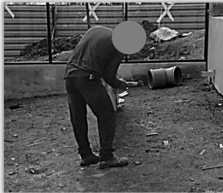
Figura 1. Risco físico: falta de protetor auditivo. Risco de acidente: ausência de equipamentos de proteção individual: óculos e luvas de segurança
