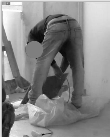
Figura 2. Risco físico: falta de protetor auditivo. Risco de acidente: ausência de óculos e luvas de segurança. Risco químico: falta de protetor respiratório
