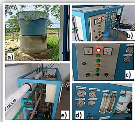
Figura 4. Componentes do sistema de dessalinização do Sítio Telha Branca.
