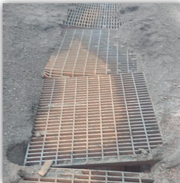
Figura 9. Grade da canaleta danificada.
