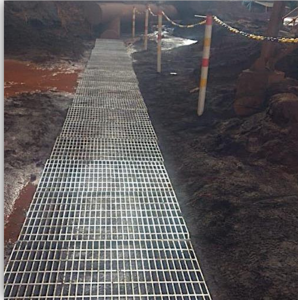
Figura 10. Grade da canaleta substituída.
