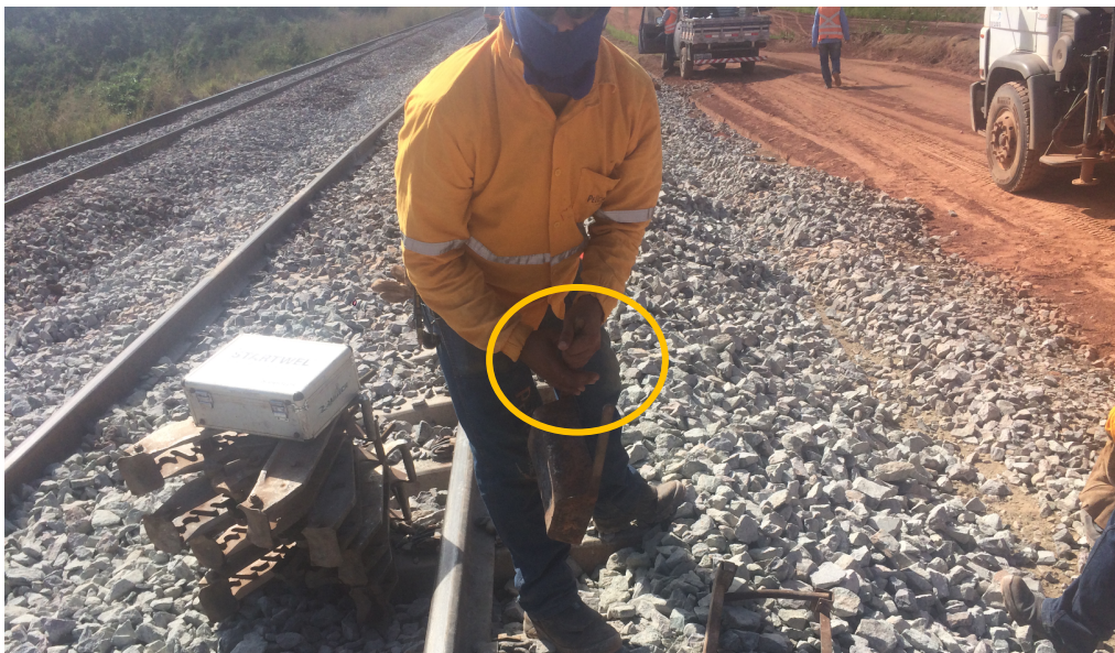
Figura 4 – Inconformidades: Ausência de luvas durante transporte de ferramentas para execução de solda a luminotérmica.
