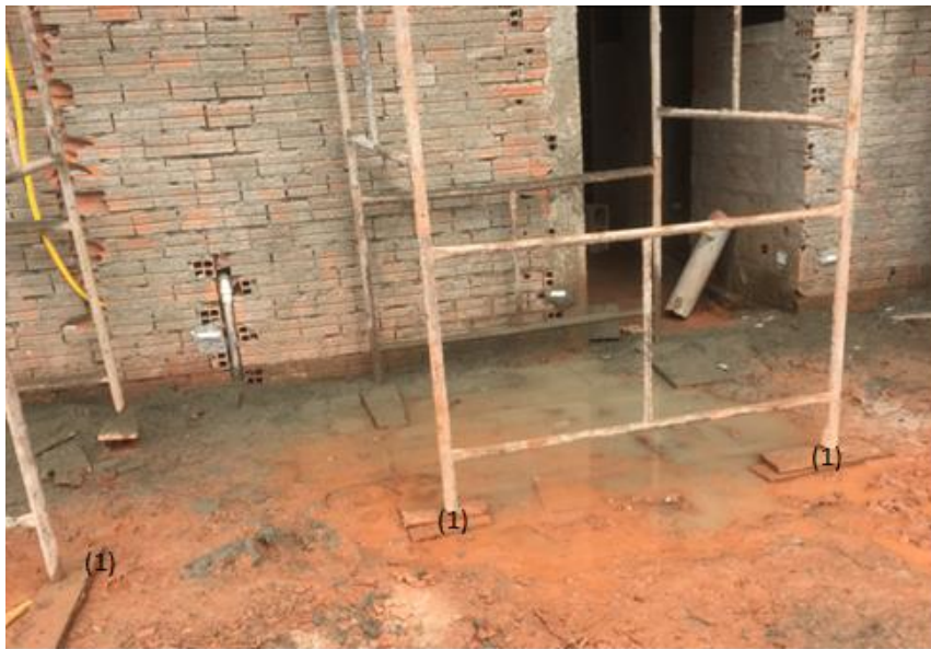
Figura 3 – Andaime da figura 2 apoiado de maneira irregular.
