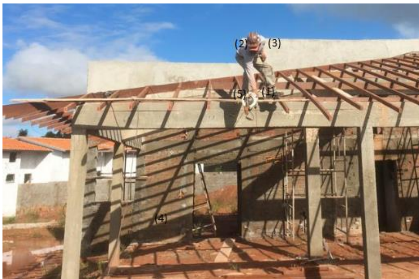
Figura 4 – Trabalhador em situação de risco por falta de: (1) uso de luvas; (2) dispositivo de segurança contra queda; (3) cabo-guia de aço; (4) sinalização e isolamento da área; (5) local adequado para serviço de carpintaria.
