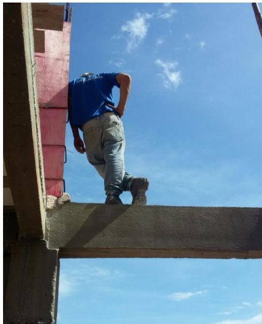
Figura 6 – Trabalhador em atitude insegura, colocando-se em situação de risco.
