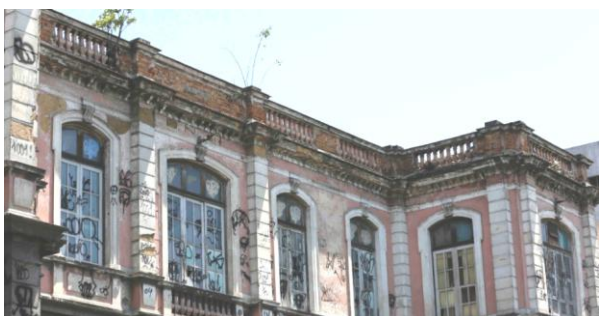
FIGURA 9: Foto mostra as esquadrias e os vidros danificados, entre outras patologias. Fonte: Marco Antônio Cavalcanti/UOL (2013)
