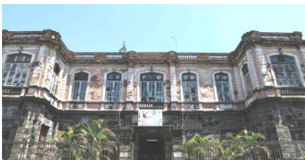
FIGURA 7: Estado de conservação atual da fachada principal do Hospital. Fonte: Marco Antônio Cavalcanti/UOL (2013)
