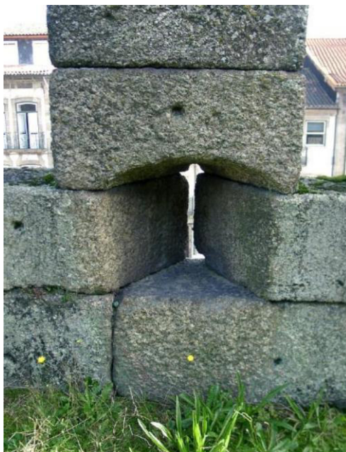
Figura 2: interior chanfrado da “seteira da muralha”. Guimarães – Portugal. Séc. X. Fonte: PATRIMÔNIO CULTURAL DE PORTUGAL. Internet, < www.patrimoniocultural.gov.pt >
