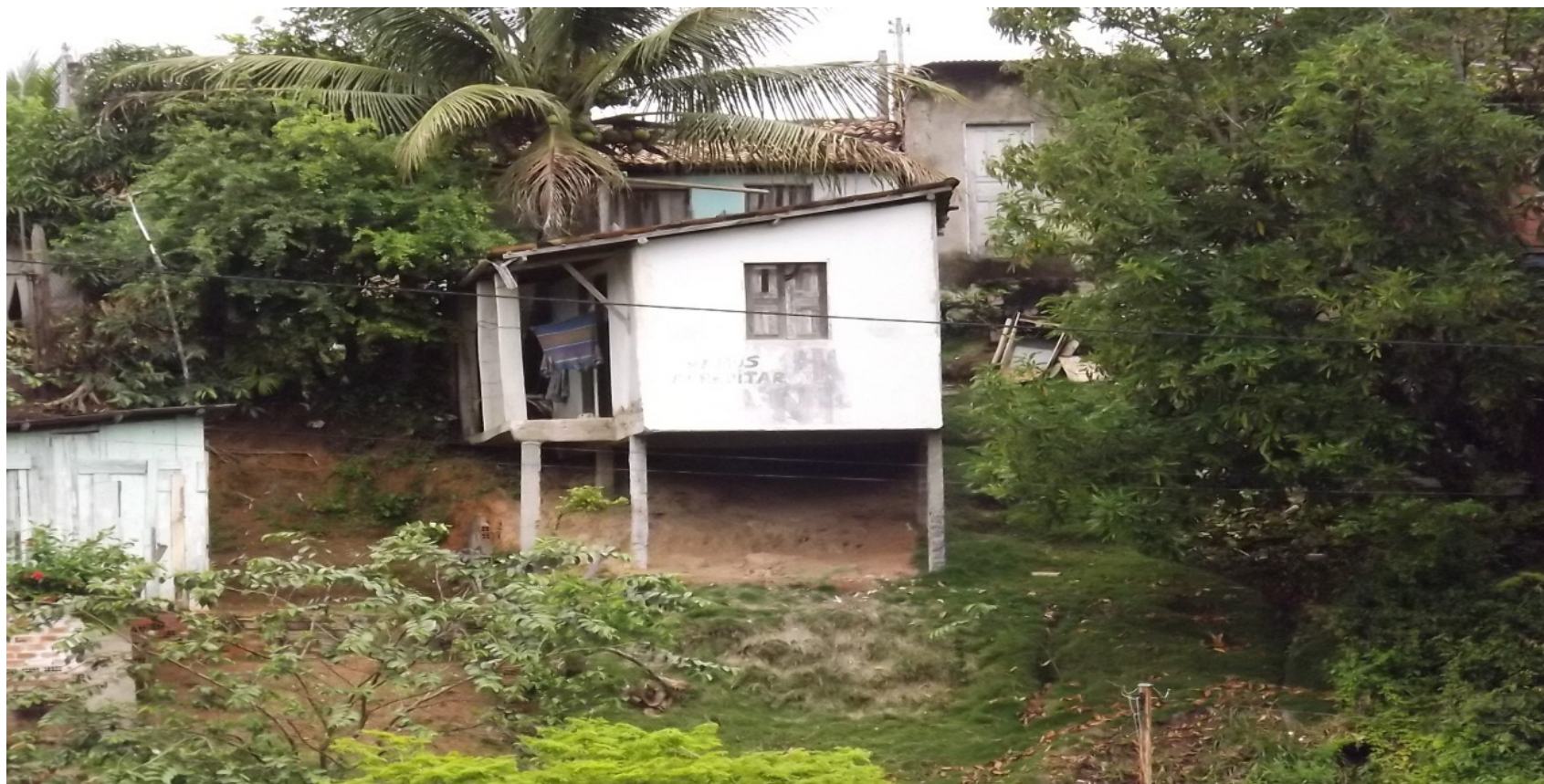
Figura 02: Construção localizada em uma área sensível ao deslizamento de solo. SILVA, L.T. nov/2011.
