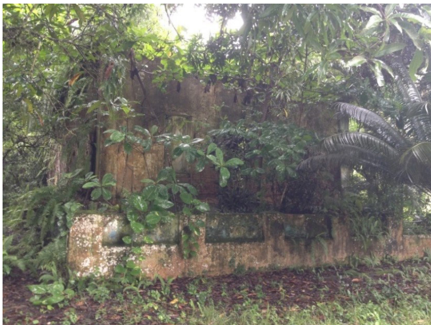
FIGURA 6 - Edificação em ruínas.
