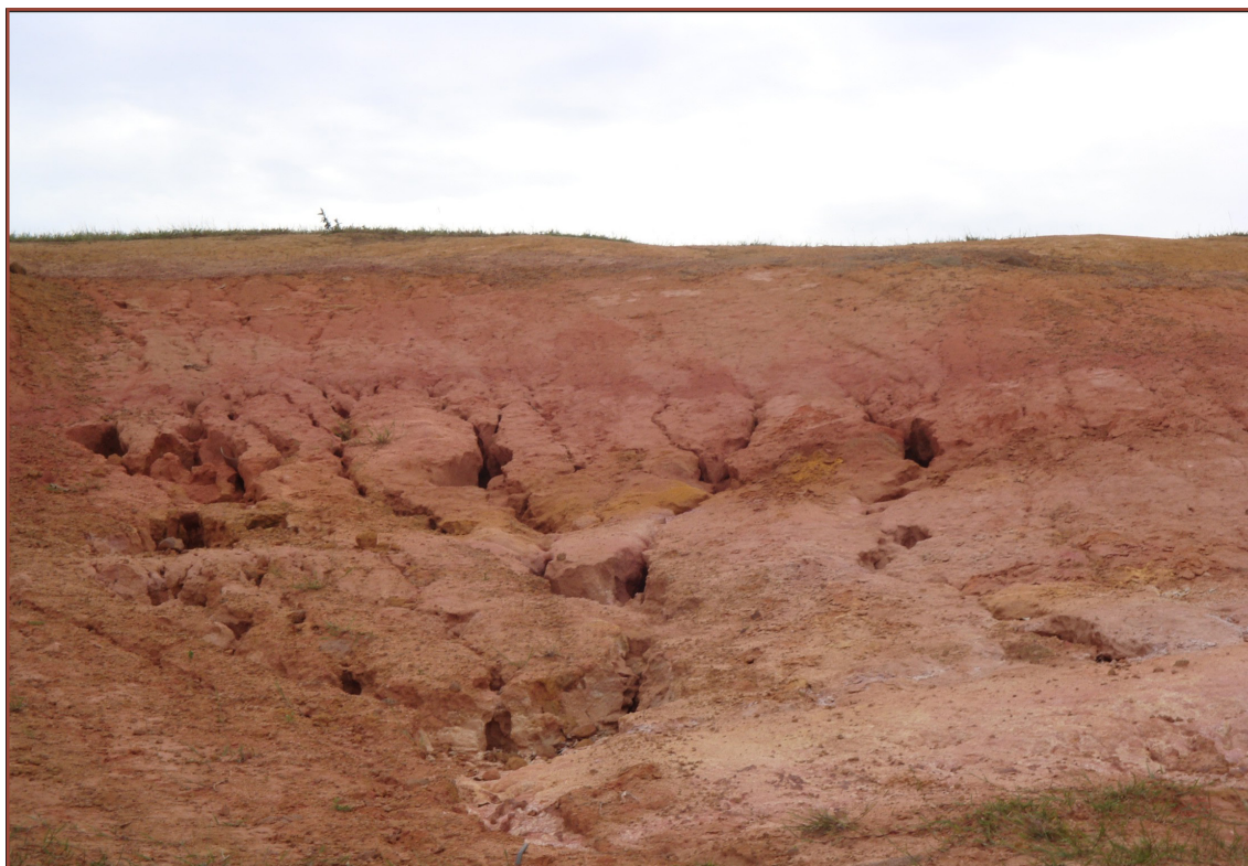
Figura 12 – Detalhe dos processos erosivos (ravinações bem desenvolvidos) no trecho mais íngreme do talude, área de empréstimo de argila
