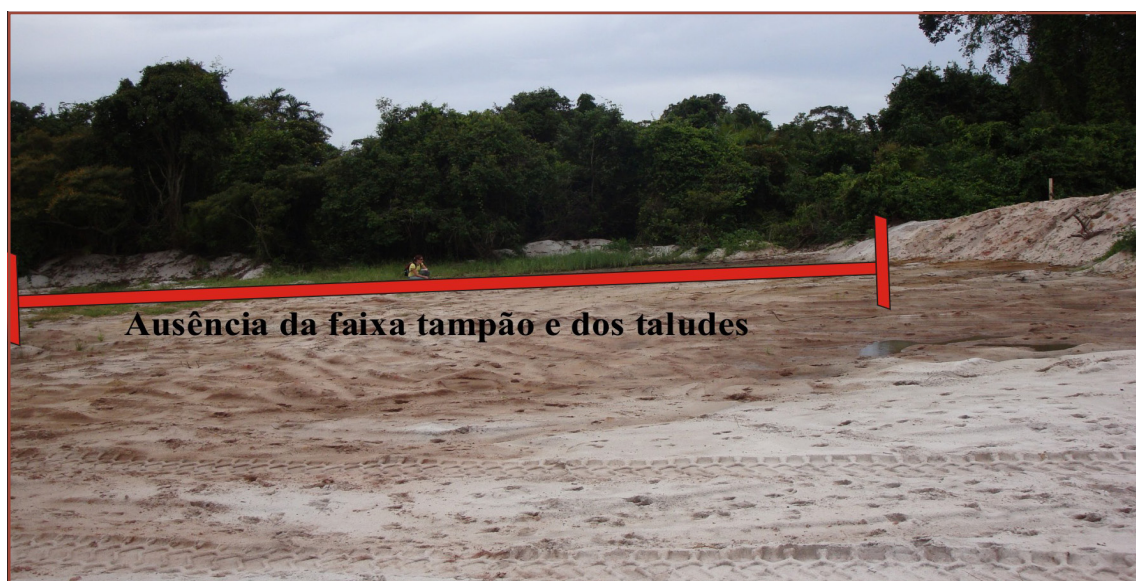
Figura 7 – Ausência da continuidade da faixa tampão da vegetação e dos taludes (A-2)
