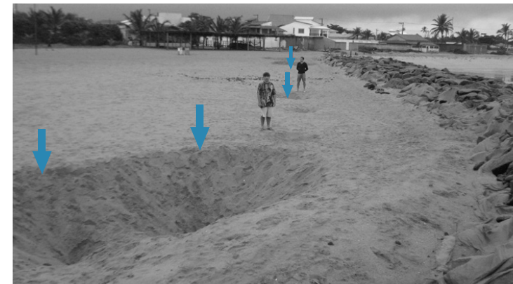
Foto 1 - Na face interna da estrutura do quebra-mar, as setas mostram os buracos de tamanhos variáveis, gerados no interior da estrutura conforme acontece a perda de sedimentos.
