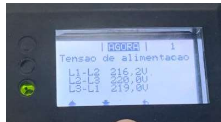
Figura 7. Parâmetros de Tensão CA (rede), medidos com o aparelho inversor on-grid da marca Fronius modelo Symo 15 kW.
