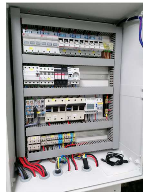
Figura 25. Detalhe do quadro de medição e proteção. Fonte: https://igenergypower.com/Home.html (2023)
