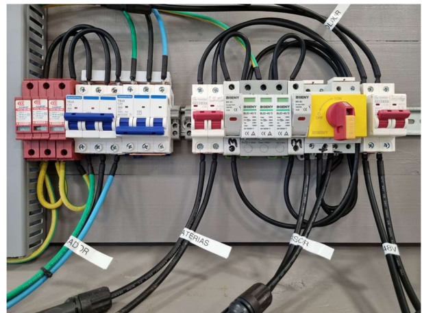
Figura 17. Sistema de proteção. Da esquerda para a direita: dispositivo supressor de surto (DPS) para o circuito ca do aerogerador, sistema de frenagem eletromagnética curto-circuitando as três fases, disjuntor cc na saída das baterias, fusíveis, DPS cc, chave seccionadora para a alimentação da string do inversor solar, disjuntor cc na saída do controlador para a alimentação das baterias (06/05/2024).
