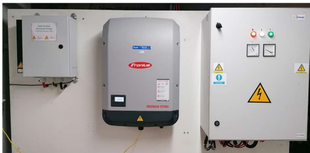
Figura 24. Da esquerda para a direita: turbine control unit (Voltsys), Fronius solar inverter e sistema de proteção. Fonte: https://igenergypower.com/Home.html (2023)
