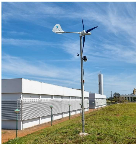
Figura 16. Modo de instalação do aerogerador GERAR 246 da marca Enersud e localização da Estação Meteorológica Davis Vantage Pro2 Agrosystem (06/09/2023).
