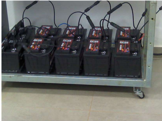
Figura 12. Banco de baterias estacionárias. 10 baterias de 12V, C100/73Ah (13/07/2023).
