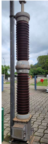
Figura 1. Transformador de potencial capacitivo objeto de estudo.
