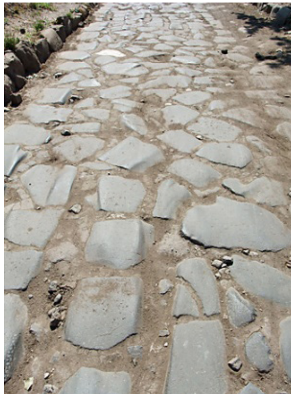
Figura 2 - Via Appia – detalhe da pavimentação na qual se evidenciam as fissuras das rodas nas pedras de calcário
