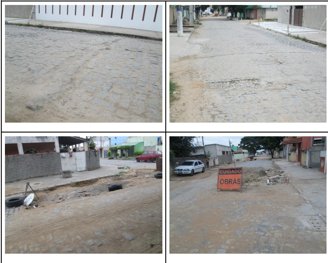
Figura 06: Quebra-molas, buracos e consertos na Rua João Manoel de Faria.
